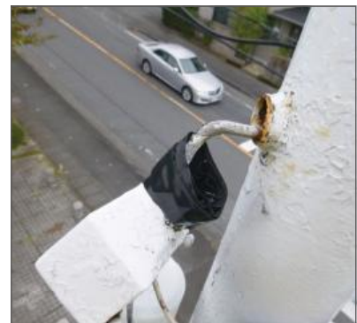
支持部の破断
